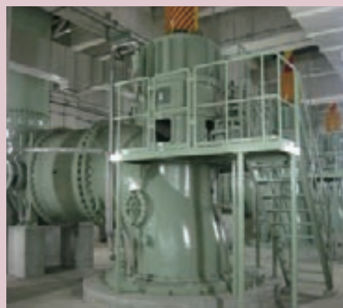
▲神谷ポンプ所雨水ポンプ設備
