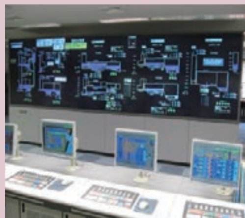
▲みやぎ水再生センター中央監視室
