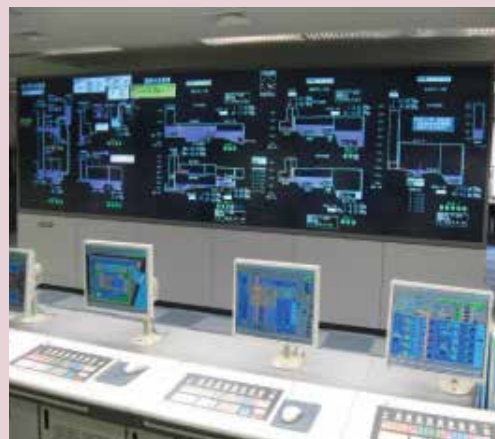
▲みやぎ水再生センター中央監視室
