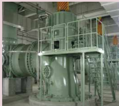
▲神谷ポンプ所雨水ポンプ設備
