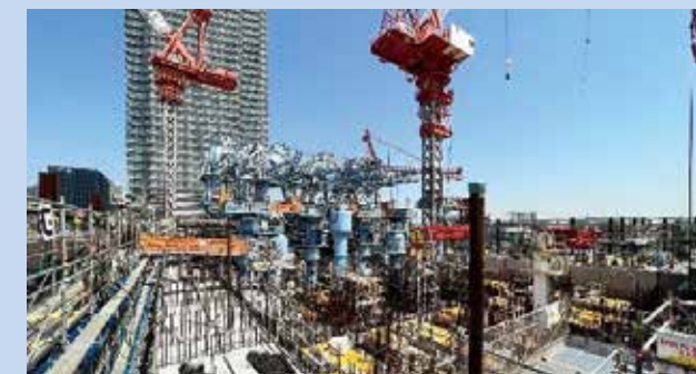
江東ポンプ所
