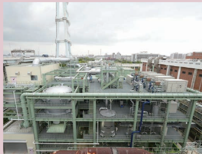
▲エネルギー自立型焼却炉
