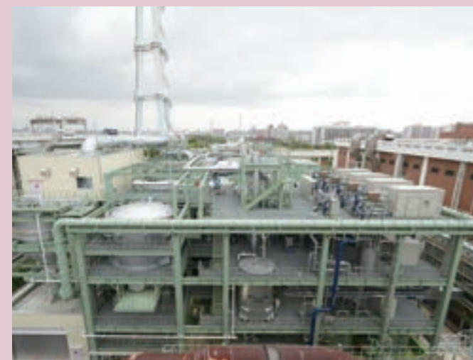
▲エネルギー自立型焼却炉
