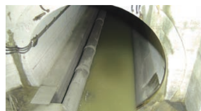
②下水道管
