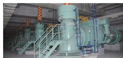
③ポンプ所
