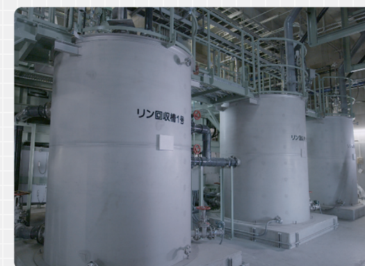
りん回収・肥料化施設
