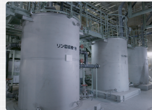
りん回収・肥料化施設
