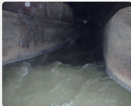
管内水位が高い下水道幹線
