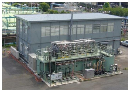
水処理実験プラントと実験棟
