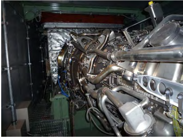
非常用発電設備（ガスタービンエンジン）
