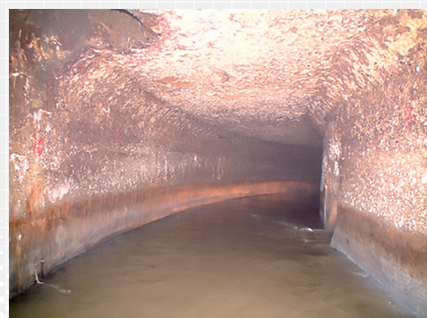
老朽化した幹線の例
