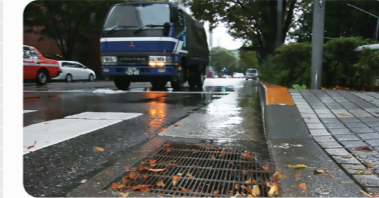
道路に降った雨水を 下水道管に集める様子
