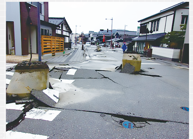
液状化現象によるマンホールの浮上 (令和6年能登半島地震)
