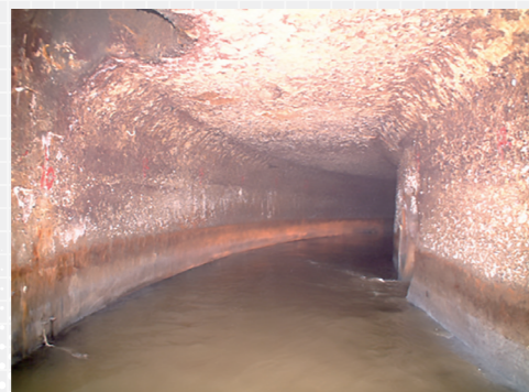
老朽化した幹線の例
