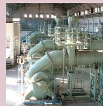
▲唧筒(ポンプ)室内
