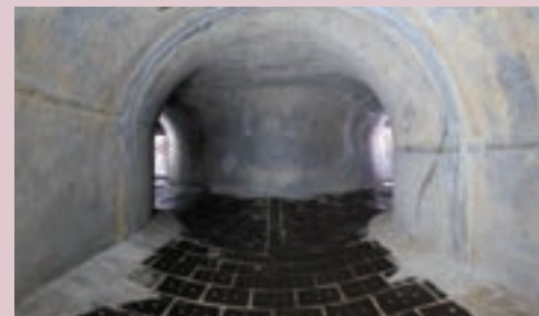
▲ 泵井连接暗渠
