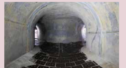
▲ 泵井连接暗渠
