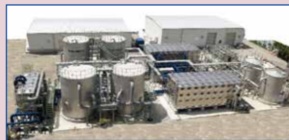
使用陶瓷膜进行过滤的再生水制造设施
