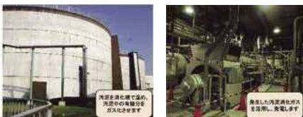
汚泥消化ガス発電（消化槽・発電機）
