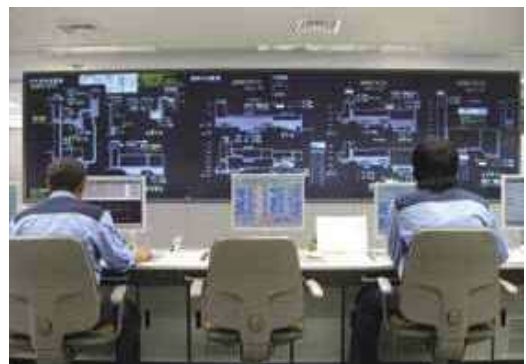
水再生センターの中央監視盤室
