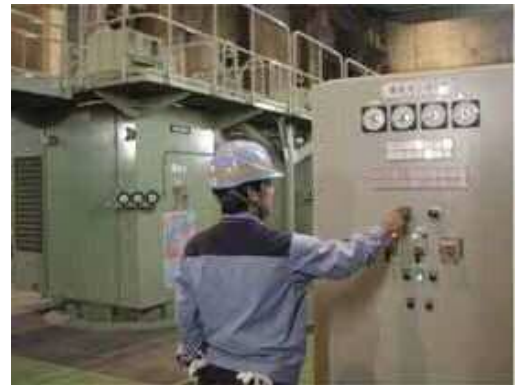
ポンプ設備の点検
