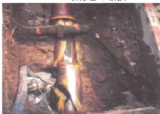
写真4-1 他企業工事による 取付管の破損
