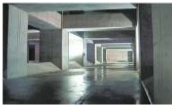
地下宮殿!? 南砂雨水調整池
