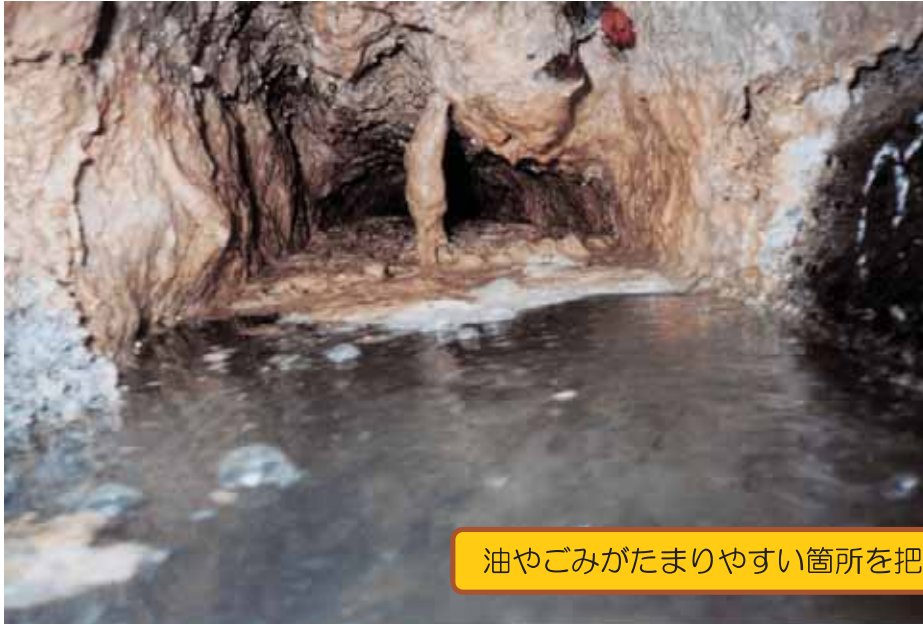
写真3-1 油が付着した管きょの内部
