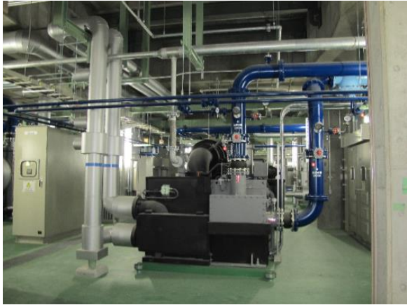
図 6 ヒートポンプ
