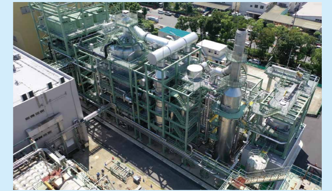
▲多層燃焼炉（新3号炉）
