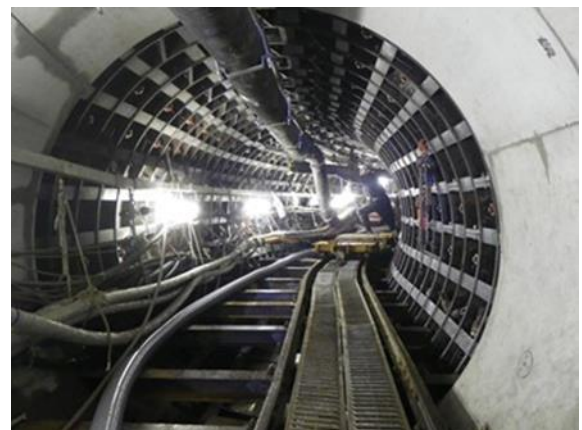
写真 4.4 急勾配手前において切離した後続台車、ホース・配管類の延長部（初期掘進方式掘削）
