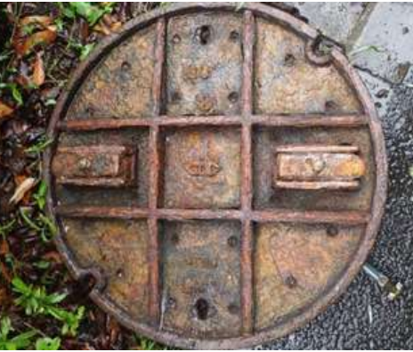
腐食したマンホール蓋 (裏側)
