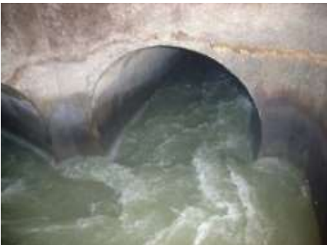
高水位の下水道管
