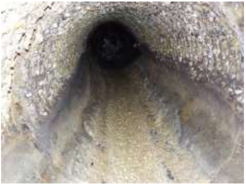
下水道管内部の腐食状況
