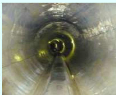
貯留施設：上目黒幹線 貯留量9,400m 3
