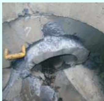
地震により破損した下水道管 (北海道胆振東部地震(2018年))
