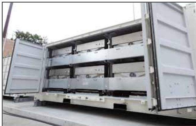
図3 新設コンテナ型NaS電池
