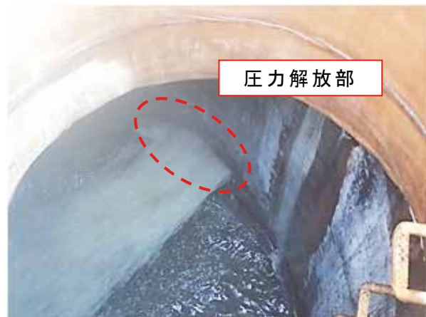
図 3 圧力解放部からの流入状況
