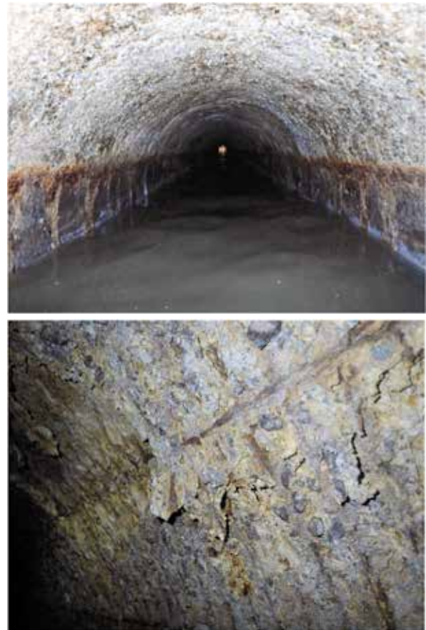
図2 管きよの劣化状況
