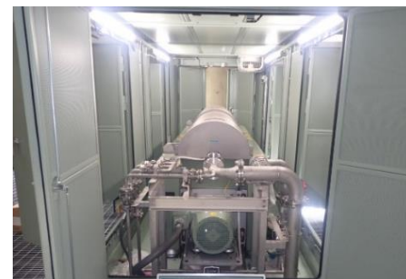
▲汚泥脱水機（浅川水再生センター）
