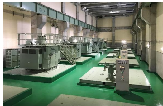
▲再構築した東尾久浄化センターポンプ室
