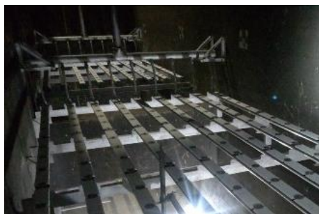
▲微細気泡散気装置（浅川水再生センター）
