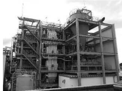
図表3-14 高効率な省エネルギー型焼却炉の例（多摩川上流水再生センター）
